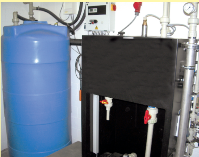
Filtrationsanlage für schmutziges Feuchtwasser an einer Zeitungsdruckmaschine.
